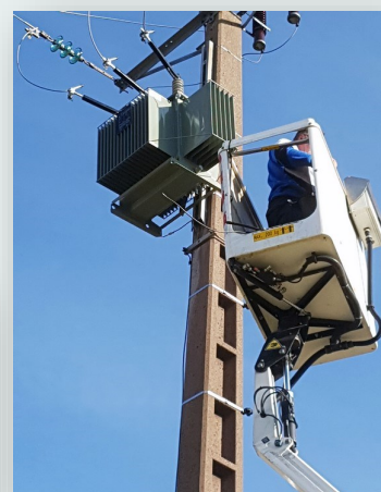
La mise en place du transformateur de la rue de la Pétrouillère
